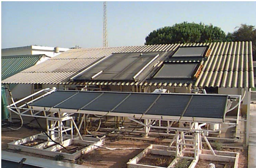
Banco de ensayo de rendimiento de captadores solares térmicos
